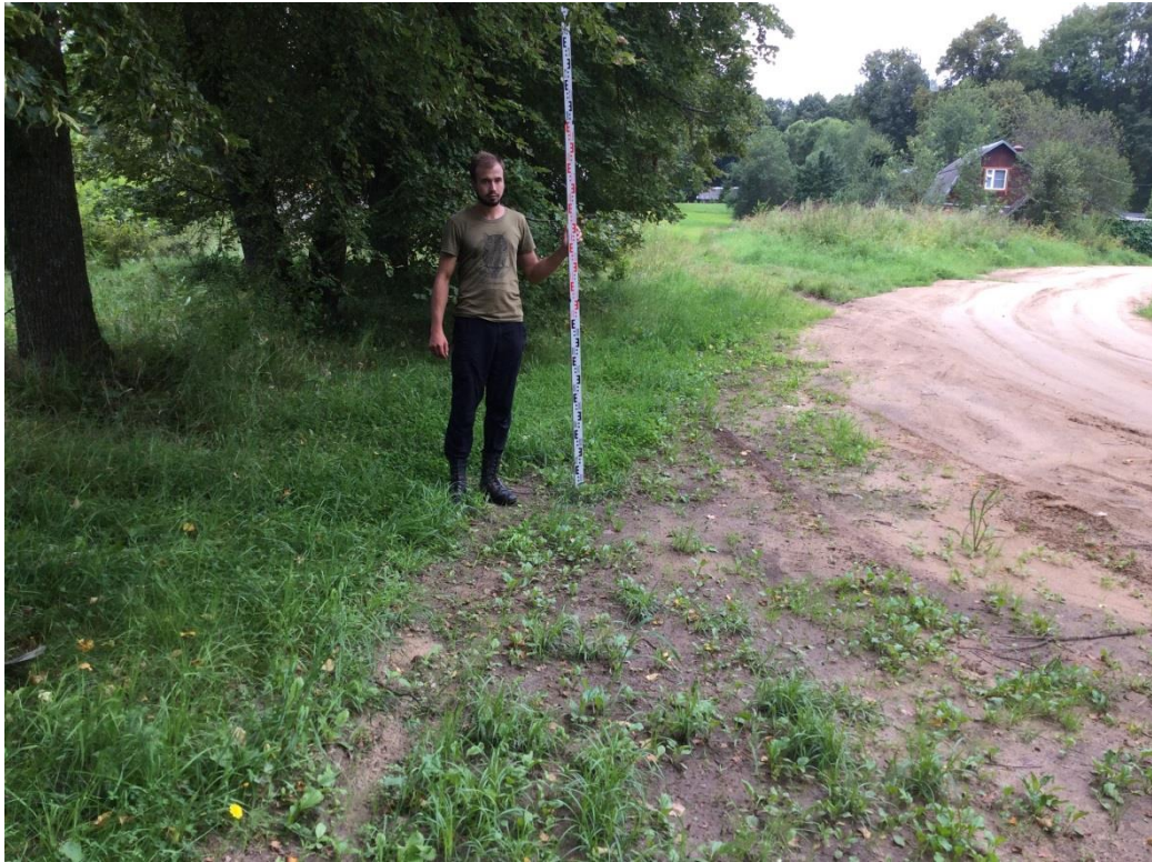
Рис. 14. Объект «Уличные газопроводы дер. Держинка Юхновского района» Калужской области. Место шурфа 1. Вид с севера.
